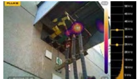
穿墙套管接头放电
