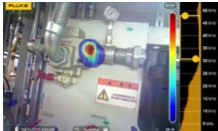
某制造企业配气室气体泄漏
