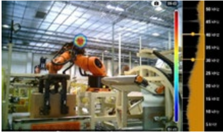
工业机器人的气压驱动关节处有泄漏
